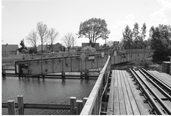
Fotografia 3. Obrotowy most kolei wąskotorowej w pobliżu Rybiny na Żuławach Źródło: D. Otta (2018)
