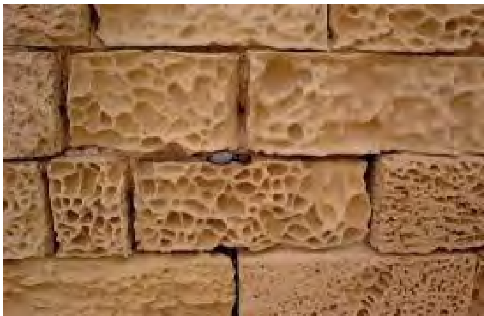
Ryc. 8.16. Kawernizacja (dziurawienie skały) jako efekt wietrzenia solnego i chemicznego w kamieniu budowlanym na Malcie
