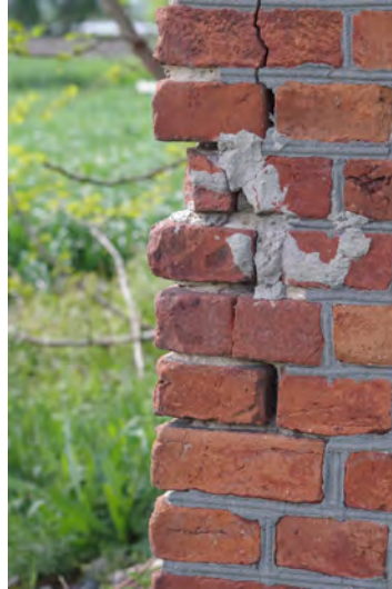
Ryc. 8.8. Zniszczenia cegieł i wapiennego spoiwa w wyniku wietrzenia mrozowego w narożach budynku
