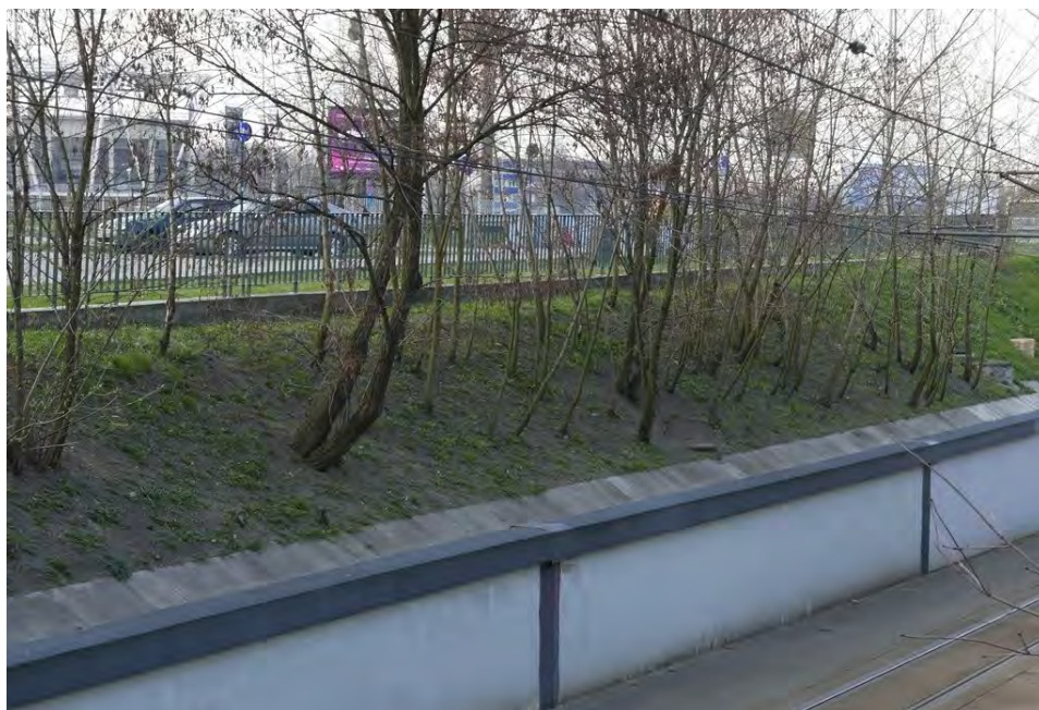
Ryc. 7.4. Wygięta dolna część pni drzew na stoku wykopu drogowego w wyniku pełzania gruntu
