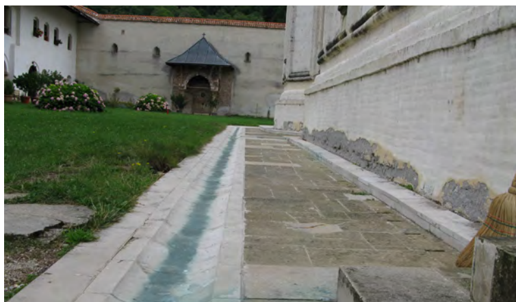
Ryc. 8.6. Łuszczenie i odpadanie tynku w strefie podsiąku kapilarnego
