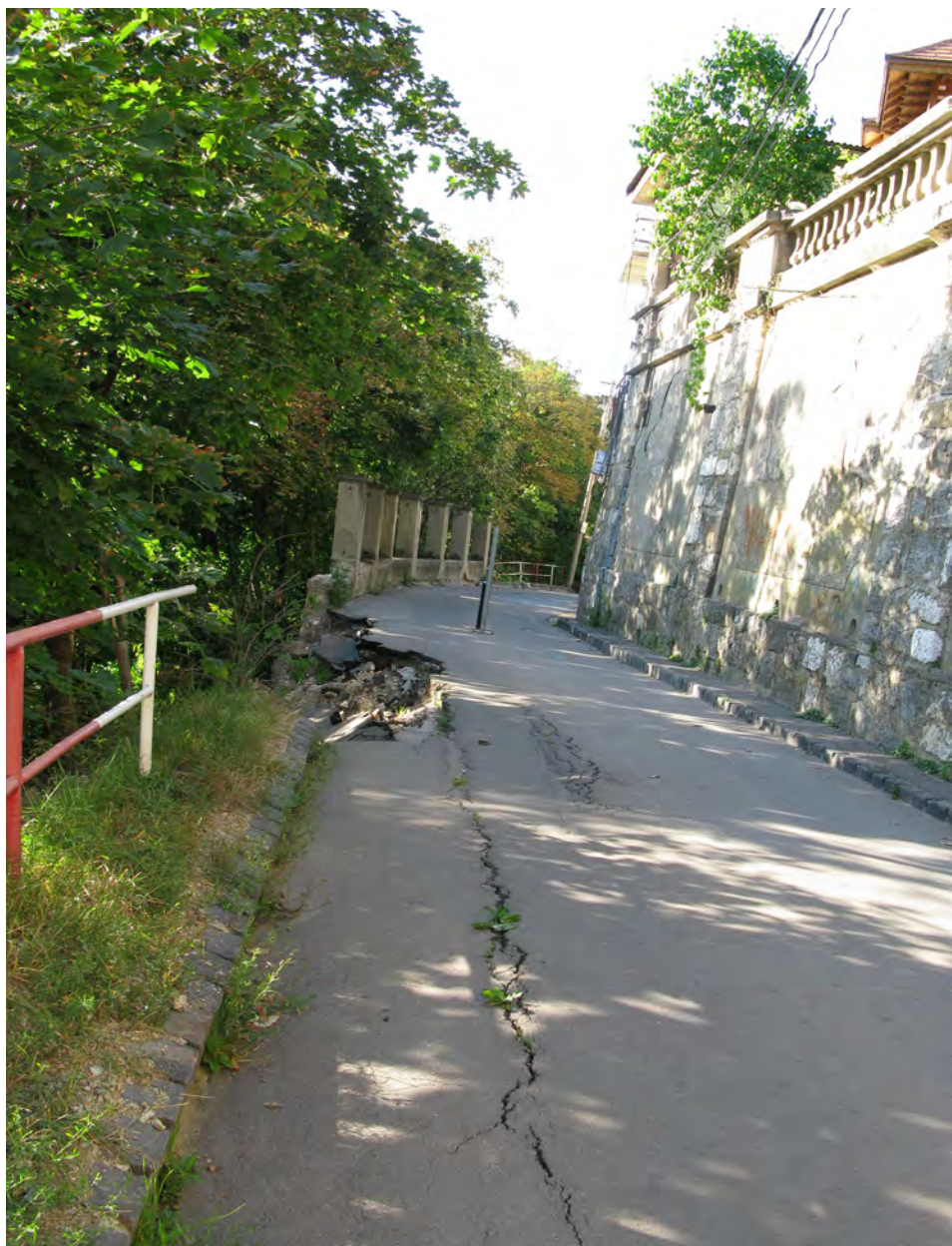
Ryc. 7.16. Przykład uszkodzonej nawierzchni drogi w wyniku rozwoju osuwiska na stoku – jest to górny fragment niszy osuwiskowej (lewa strona fotografii). Cofanie się niszy osuwiskowej może spowodować wzrost zagrożenia dla zabudowy w górnej części stoku, zabezpieczonej obecnie murem oporowym
