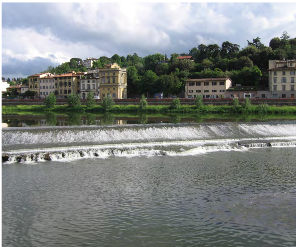
Ryc. 6.9. Przykład progu betonowego w obrębie koryta rzecznego, którego celem jest zmniejszenie tempa erozji dennej na obszarze zurbanizowanym
