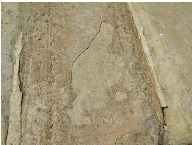
Ryc. 8.4. Łuszczenie kamienia budowlanego oraz rozkruszanie i ubytek łączenia w wyniku zamrozu
