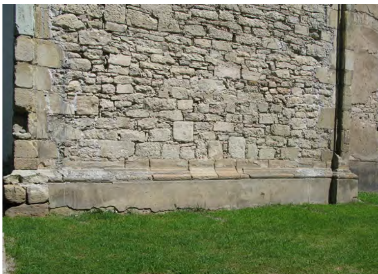
Ryc. 8.5. Niszczenie kamienia budowlanego w wyniku wietrzenia mrozowego oraz łuszczenie i opadanie tynku na styku z gruntem w wyniku podsiąku kapilarnego wody
