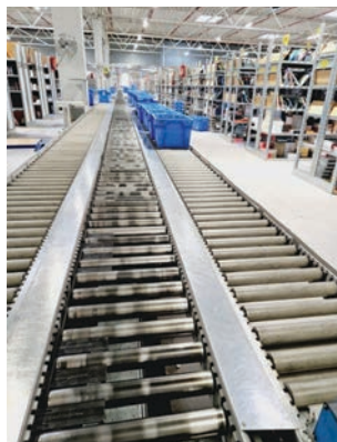
B – system przenośników
