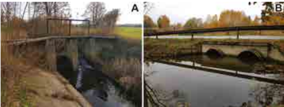
Fot. 7.10. Zastawka na Pisi II (A) i przepust z piętrzeniem na Dobrzyńcu (B)
